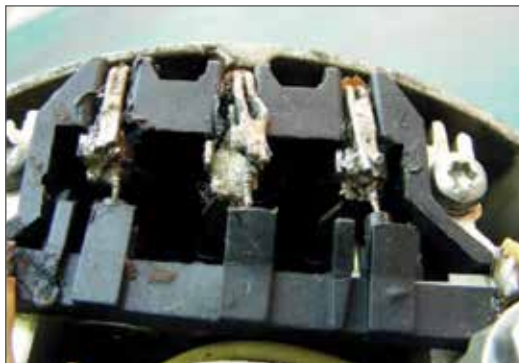
Fig. 4.02 - Soldadura dañada o inexistente en los terminales del puente rectificador.
