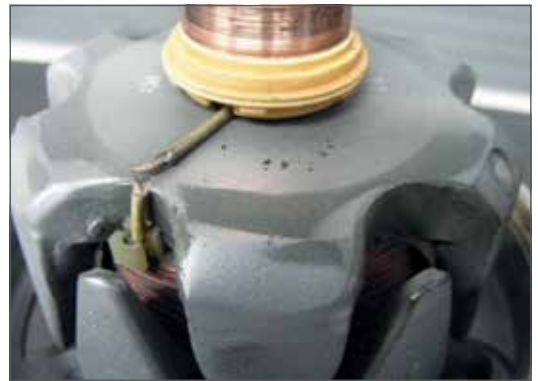
Fig. 1.04 - Rotación bloqueada del rotor y rotura de la bobina.
