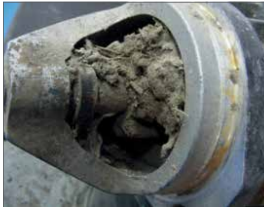
Fig. 4.03 - Bloqueo del movimiento de avance, rotación y retorno del impulsor.
