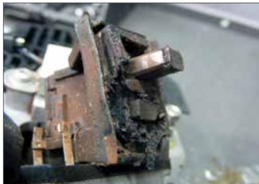
Fig. 2.02 - Recubrimiento de sellado de las escobillas del regulador de tensión quemado.
