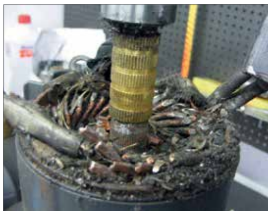
Fig. 2.01 - Colector y portaescobillas totalmente destruidos.
